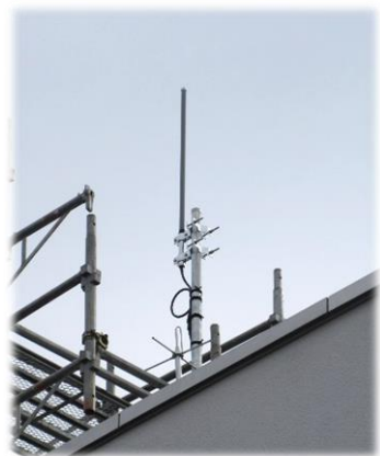
▲設置されたアンテナ
