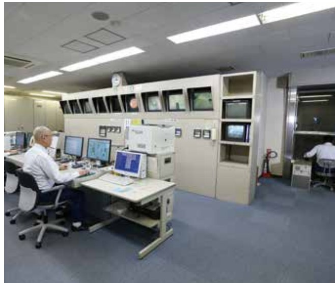
中央操作室 焼却施設の運営に関する全てのデータを集中管理する場所です。焼却炉の監視のほか、クレーンの操作を行っています。
