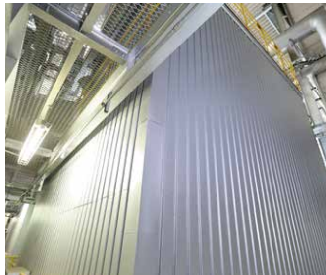
集じん装置 排ガス中の灰や有害物質を取り除くための設備です。390本のろ布と呼ばれるフィルタが装置内に設置されています。入口で薬剤を吹き込むことでダイオキシン類や塩化水素、硫酸酸化物を低減できます。
