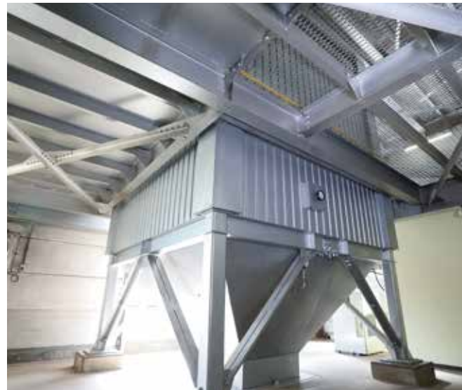
触媒脱硝塔 集じん装置を通過した排ガスをさらに処理する設備です。ハニカム状の触媒が3層に設置されており、この触媒を通過させることでダイオキシン類の分解除去が可能となっています。
