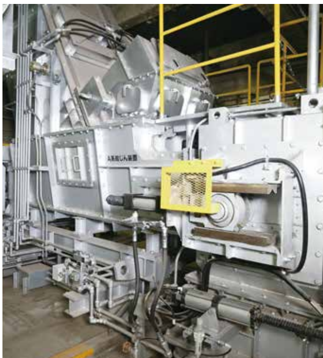
給じん装置 二軸スクリーンで構成され、ごみを連続して定量的に直接焼却炉に供給します。
