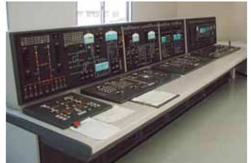
監視室の様子
