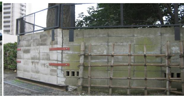
不適切なブロック塀
