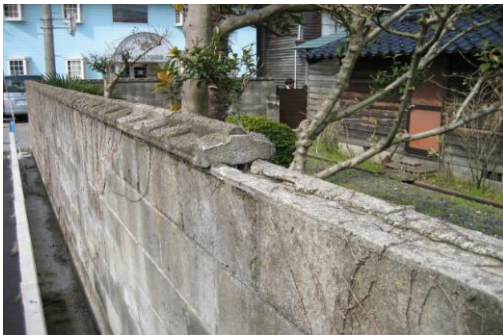
笠木が落下したブロック塀
