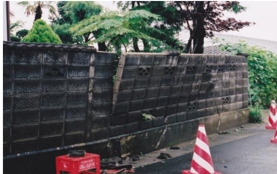
明らかに劣化し危険なブロック塀
