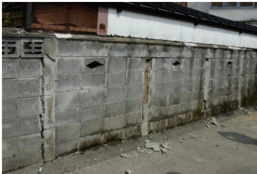
劣化したブロック塀
