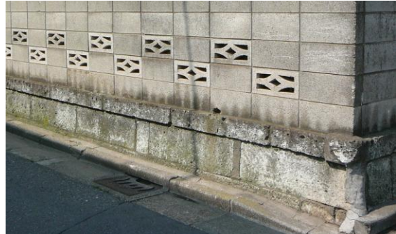
大谷石が劣化したもの
