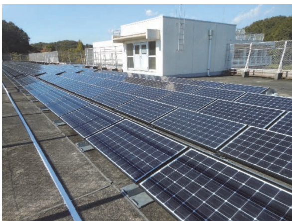
小・中学校の屋根貸し太陽光発電設備
