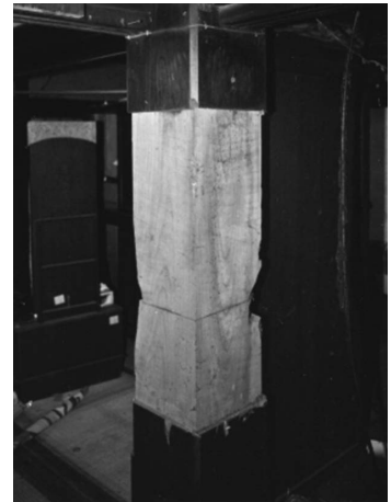
写真 1-21 打ちこわしによる柱のきず
