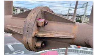
写 8 - 66 横梁腐食 健全度
