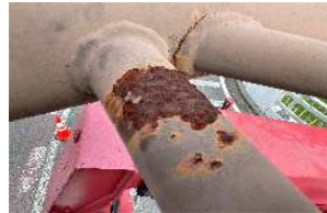
写 6 - 66 横梁腐食 健全度
