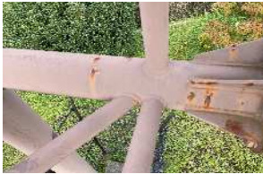
写 5 - 66 横梁腐食 健全度
