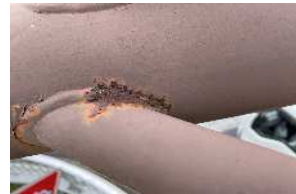
写 7 - 66 横梁腐食 健全度
