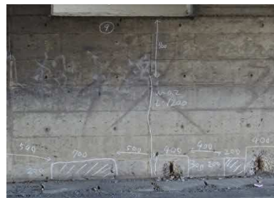
写8 - 東所沢アンダーパス 隔壁剥離・鉄筋露出 健全度 II、対策区分C1
