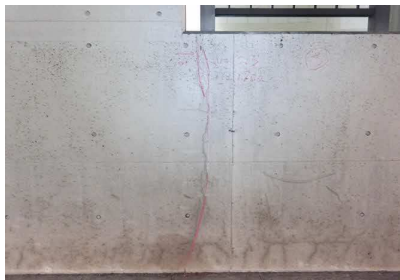
写5 - 上新井跨道橋 隔壁ひびわれ 健全度 I、対策区分B
