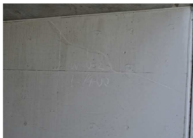
写7 - 狭山ヶ丘跨道橋 側壁ひびわれ 健全度 I、対策区分B
