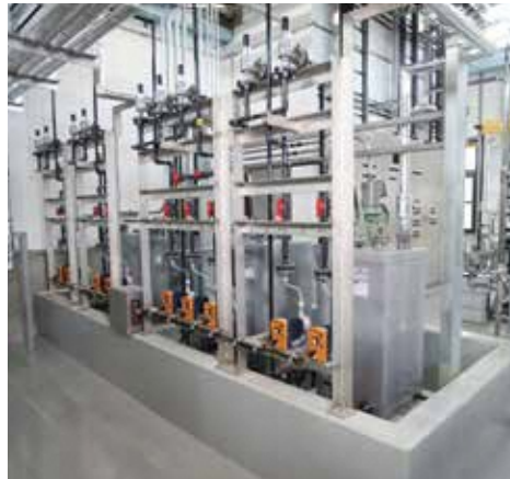
薬品注入設備
