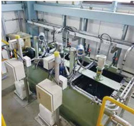
アルカリ凝集沈殿処理設備
