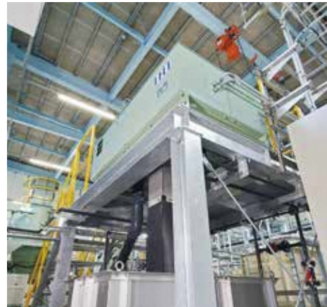
汚泥処理設備
