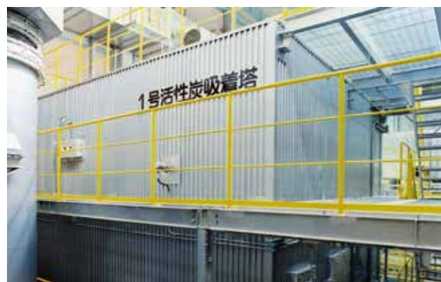
活性炭吸着塔
