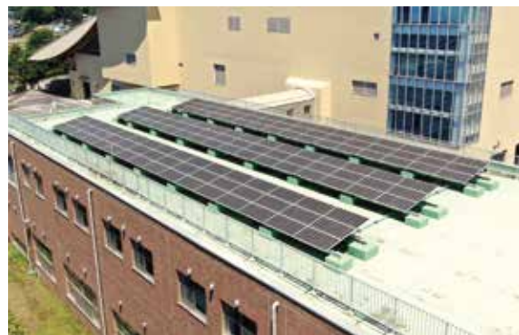
太陽光発電（管理棟上）
