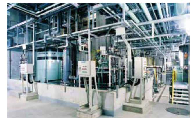
プラント排水処理設備
