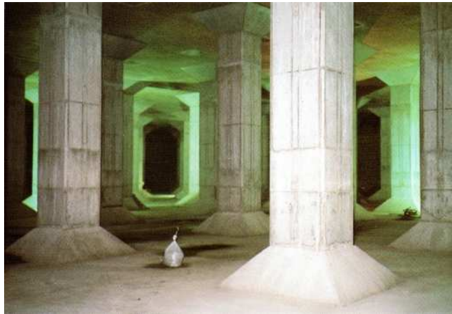
緑町中央公園調整池（地下式）
