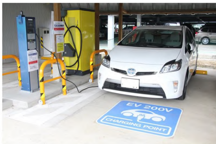
所沢市民体育館 EV 充電器 (急速充電器1基、普通充電器1基)
