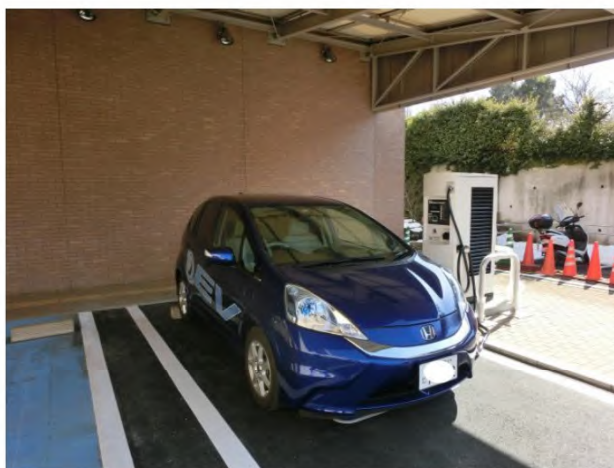
東部クリーンセンター EV 充電器 (急速充電器1基)
