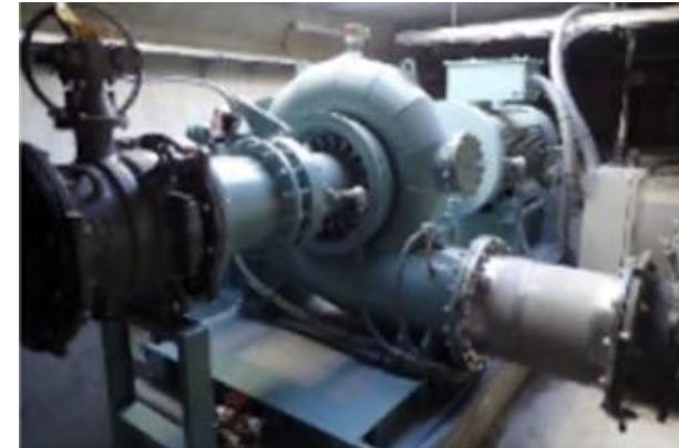
浄水場 小水力発電
