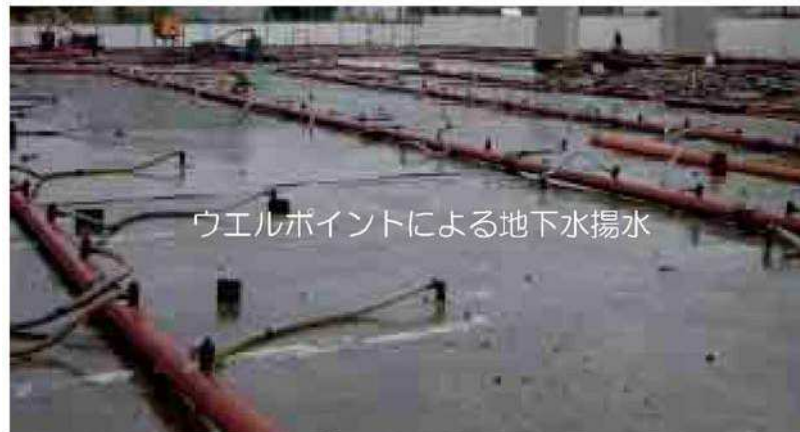
図 8-12 地下水揚水の概況写真
