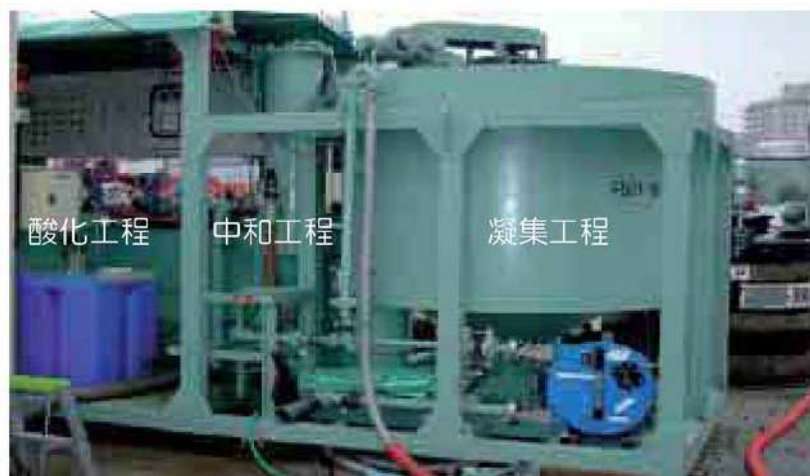
図 8-13 酸化、中和、凝集装置の概況写真
