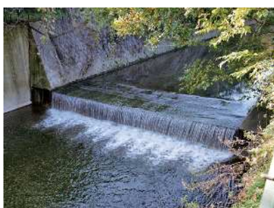
河床の段差 (東川)
