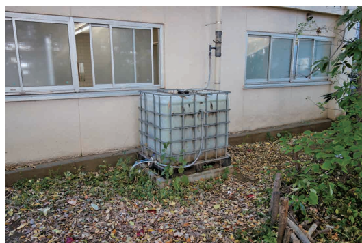
雨水タンク（清進小学校）
