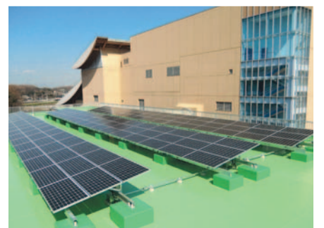
▲東部クリーンセンター太陽光発電システム
